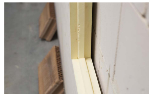
Zdjęcie nr 9. Widok na prawidłowo ustawiony zamek.
