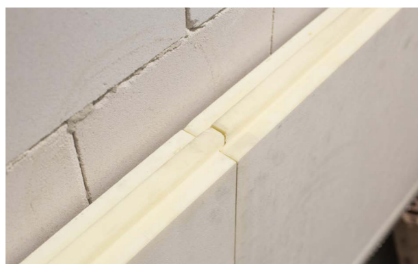
Zdjęcie nr 7. Widok na prawidłowo ustawiony zamek.
